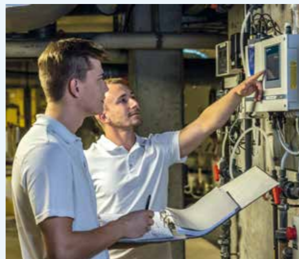
Daniel Legat (li.) und Philipp Groer (re.) prüfen und protokollieren die Anzeigenwerte der Mess-, Steuer- und Regeltechnik-Anlage im Westbad.
