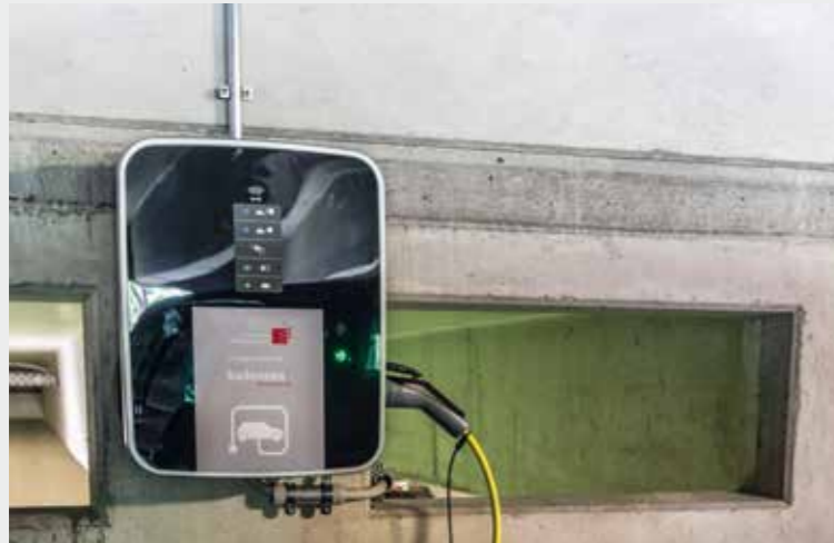
E-Ladestation in der Schlossberggarage
